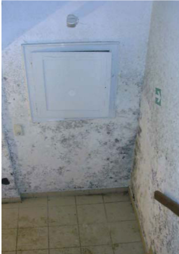
Erhöhte Mauerwerksfeuchte in einem Kellerraum
